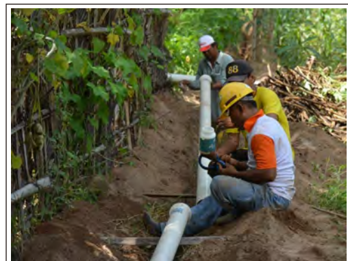
Instalasi air tanah, PIPA PAT Prop. NTB-Lombok Barat
