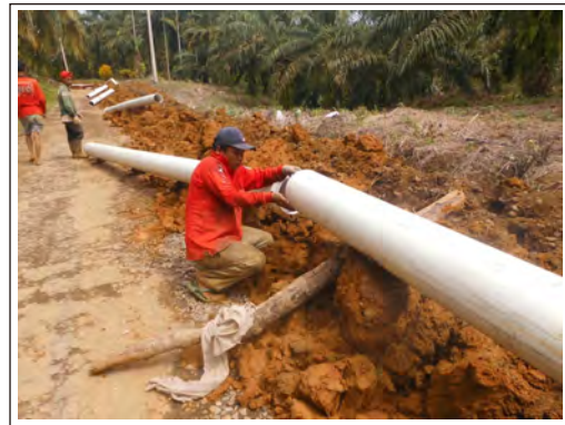
Jaringan Pipa Air APBD Ujung Gading Sumatera Barat
